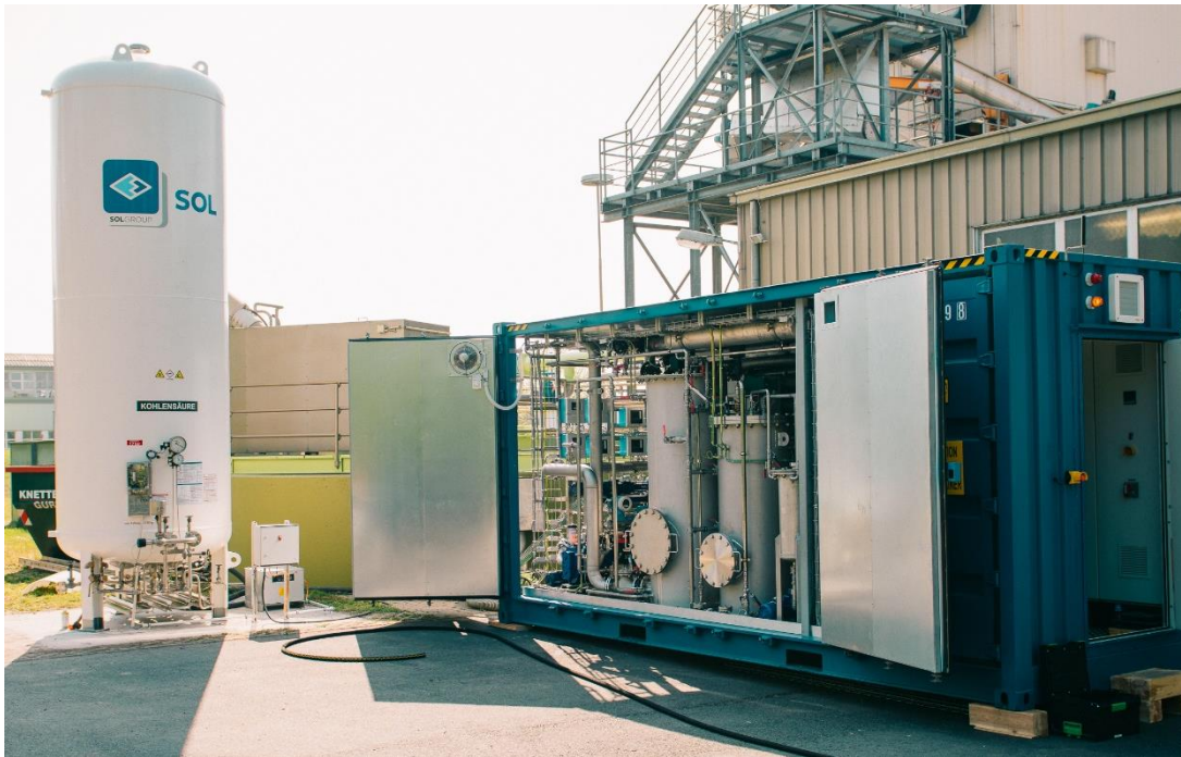
Abbildung 2: ExtraPhos ® -Pilotanlage und CO 2 -Tank an der Kläranlage Mainz-Mombach
